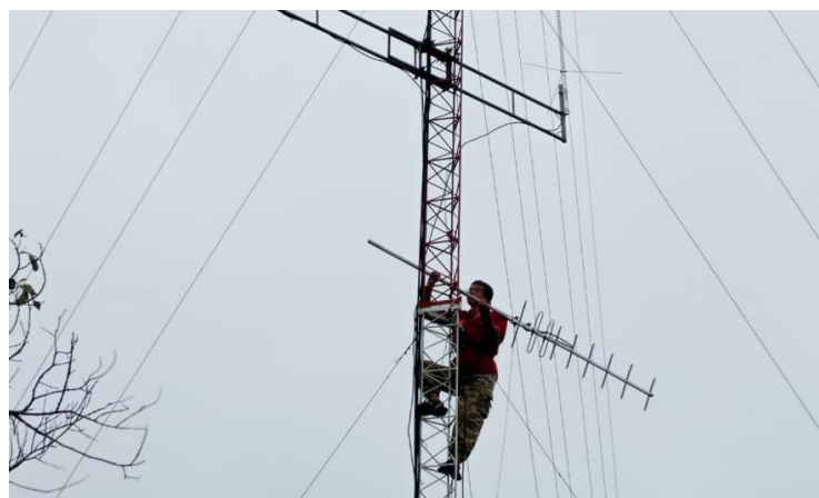
Gambar 6. Instalasi antena di stasiun link Nglanggeran
