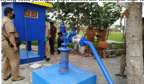
Gambar 3. Infrastruktur pipa air bersih
