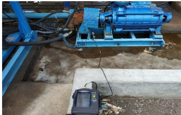
Gambar 3. Instalasi Pompa Air
